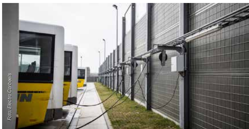
Er werden 25 individuele batterijladers voor de bussen geïnstalleerd en aangesloten.
