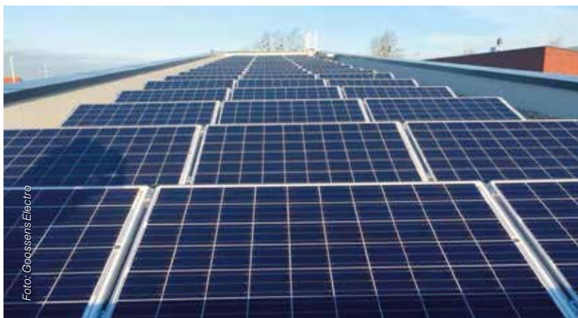
Op de platte daken van de beide gebouwen liggen een 100-tal zonnepanelen, goed voor een totaal vermogen van 25.000 kW/uur.
