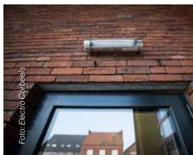
Electro Corbeels stond ook in voor de installatie van ledverlichtingsarmaturen, zowel buiten- en binnerverlichting als noodverlichting.
